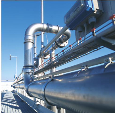
Pressfitting-Systeme aus nichtrostendem Stahl eignen sich auch für eine Vielzahl chemischer Produkte. Foto: Raccorderie Metalliche, Campitello di Marcaria, MN (I)
